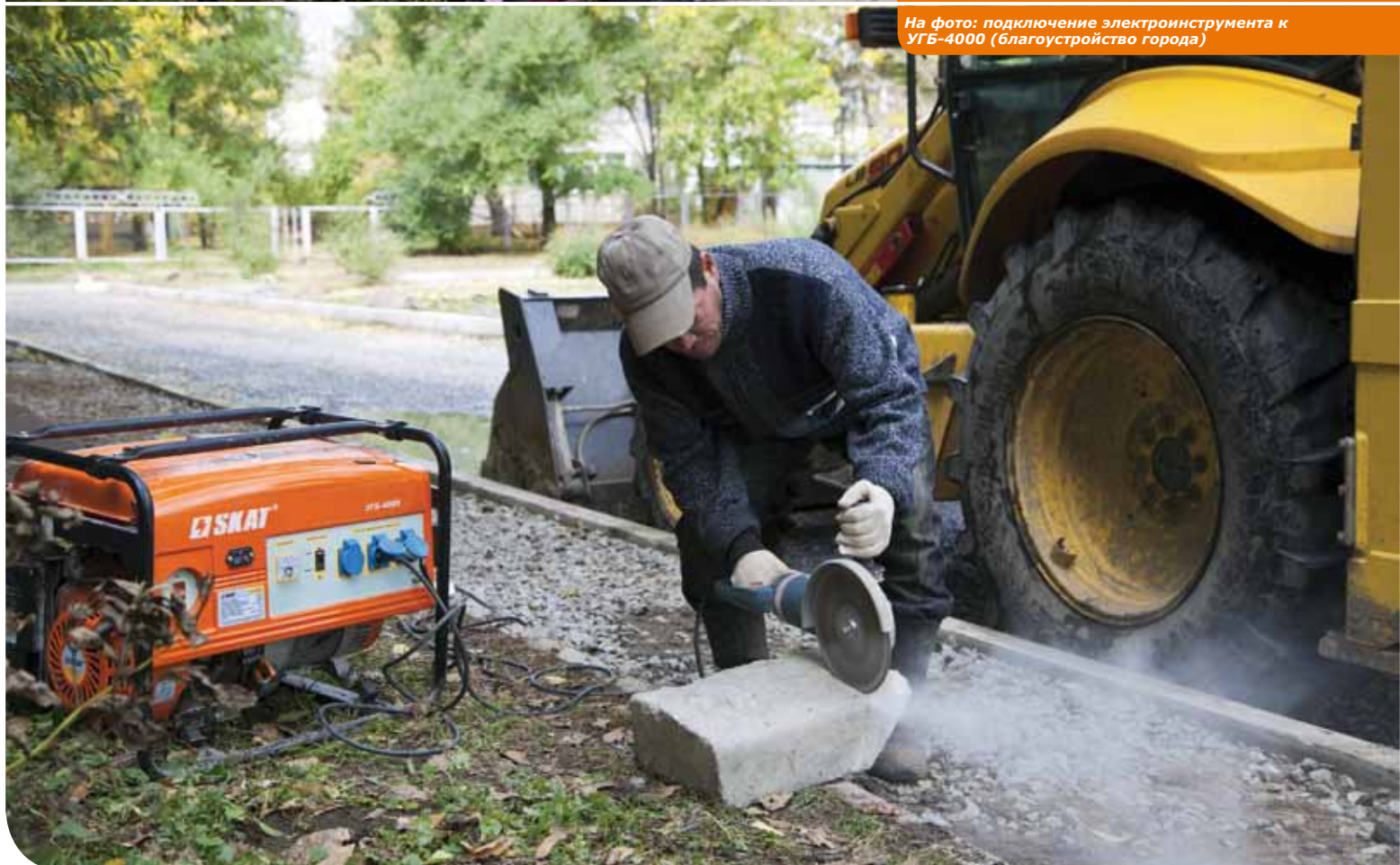
На фото: использование УГБ-2000 в качестве резервного источника питания
