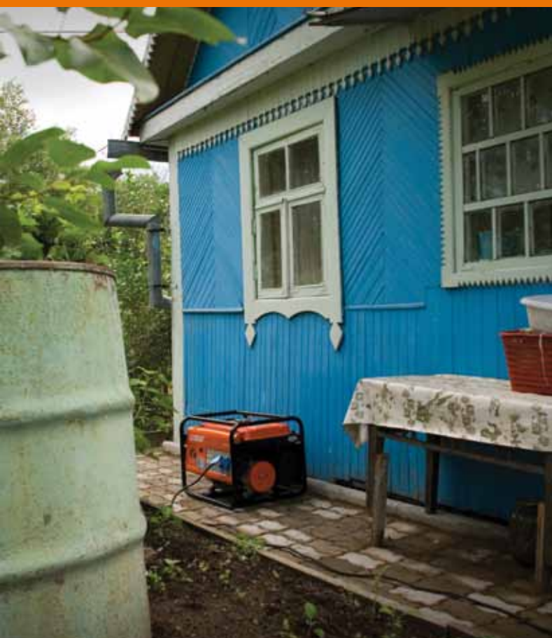
На фото: использование УГБ-2500 в качестве постоянного источника питания
